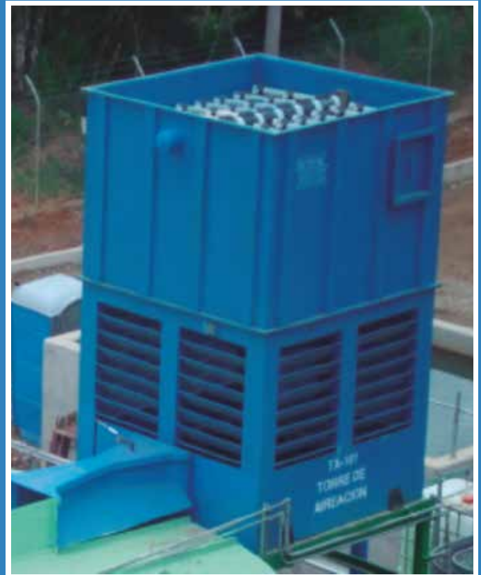
TORRE DE AIREACIÓN EMPACADA
