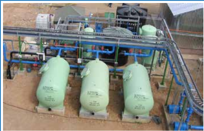
FILTROS DE ARENA ANTRACITA HORIZONTALES
