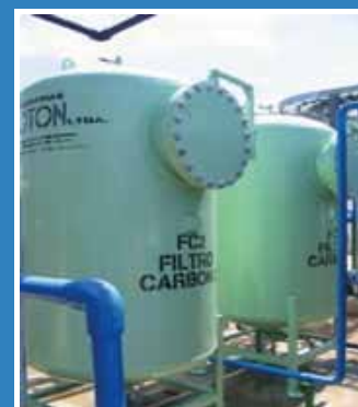
FILTROS DE ARENA Y CARBÓN ACTIVADO
