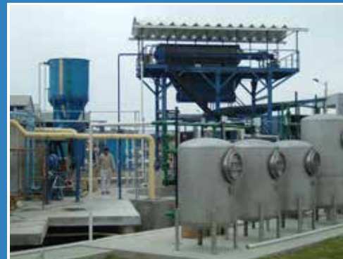
SISTEMAS DE DESHIDRATACIÓN DE LODOS
